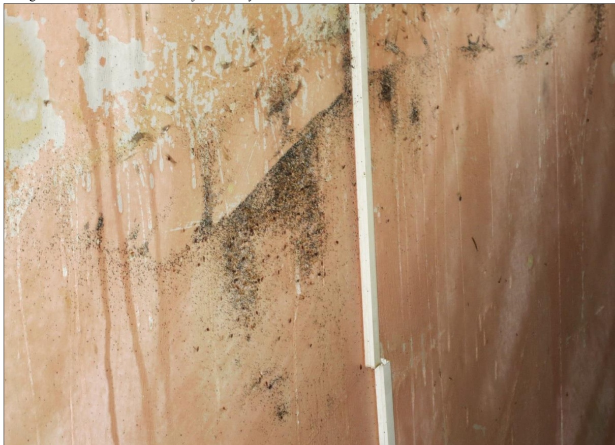
Fotografie č. 20: Hnízdo štěnic na jedné z ubytoven
