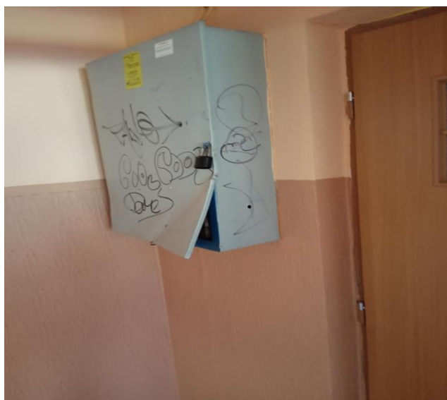
Fotografie 2: Zničené vybavení společných prostor 31
