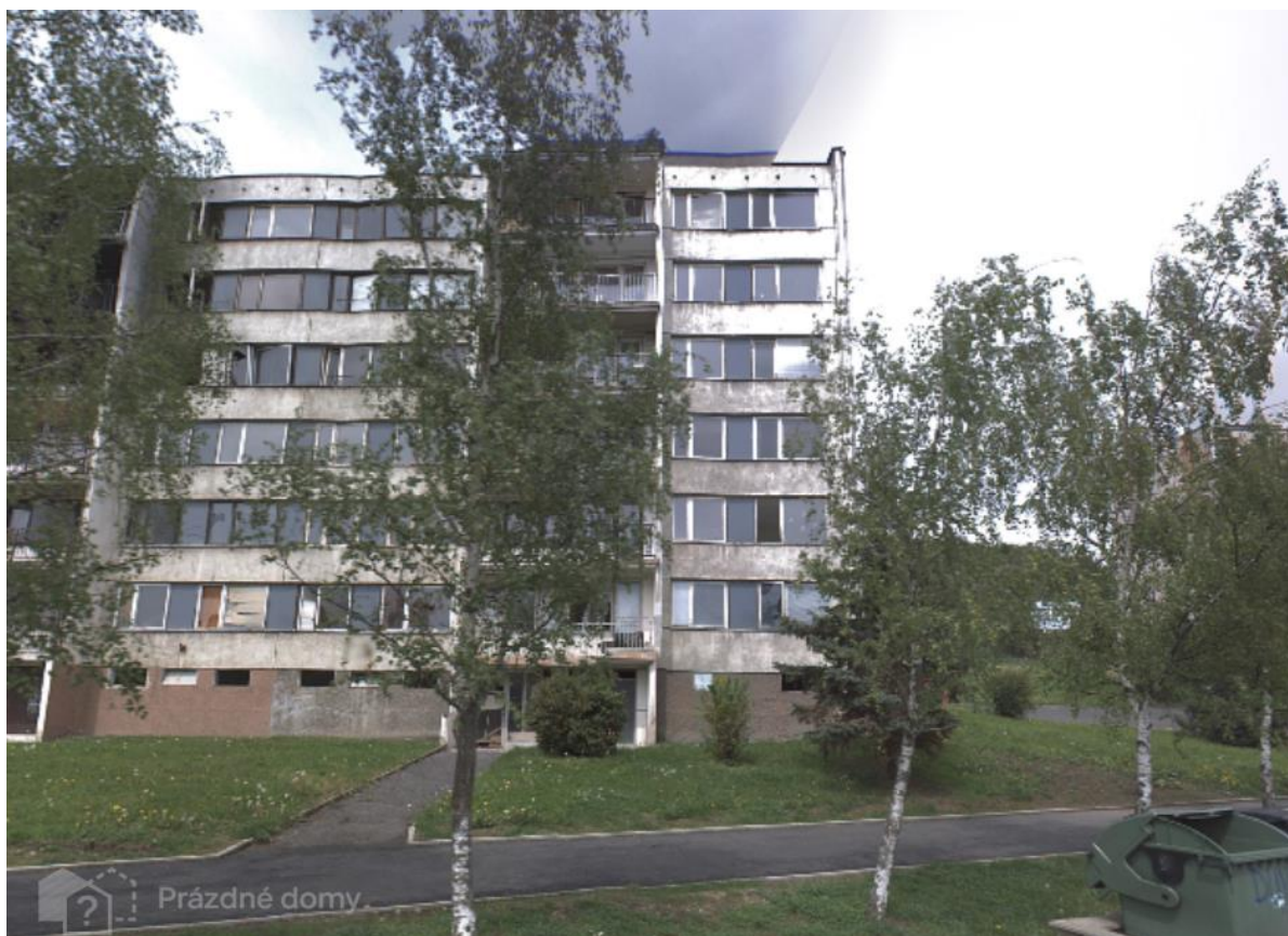
Obr. 4: Stav domu v roce 2015, tedy v době opuštění objektu. Zdroj: Prázdné domy.
